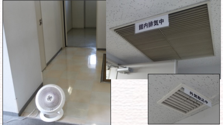
サーキュレーター
